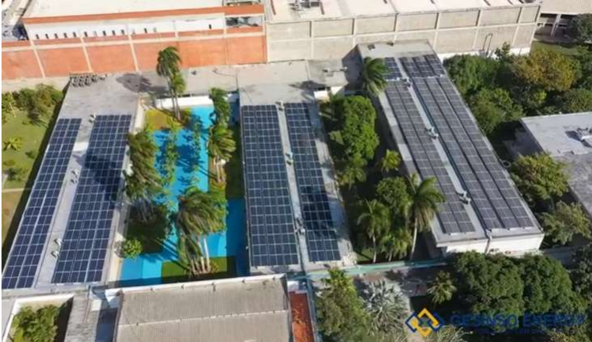
Figura 4 Paneles solares instalados en la infraestructura de la Corporación Universitaria Reformada ((Pinto, 2020)
