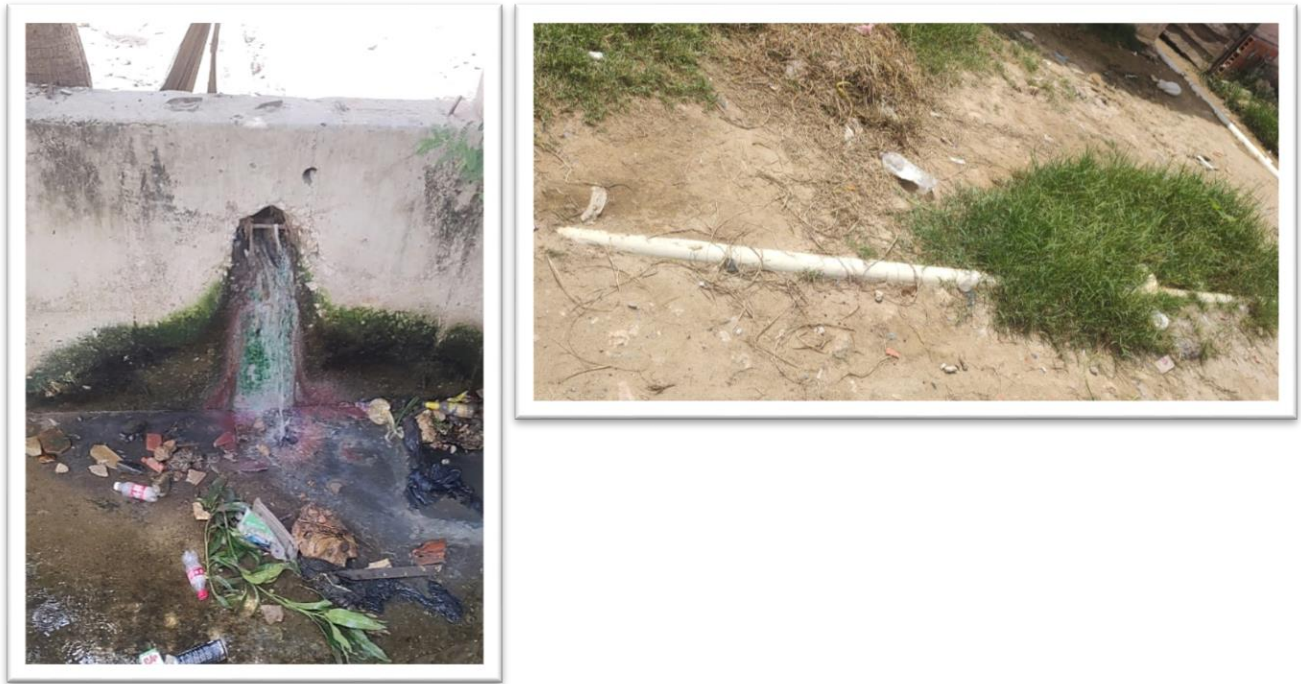
Figura 8. Tuberías expuestas y sistema de alcantarillados dirigidos al arroyo
