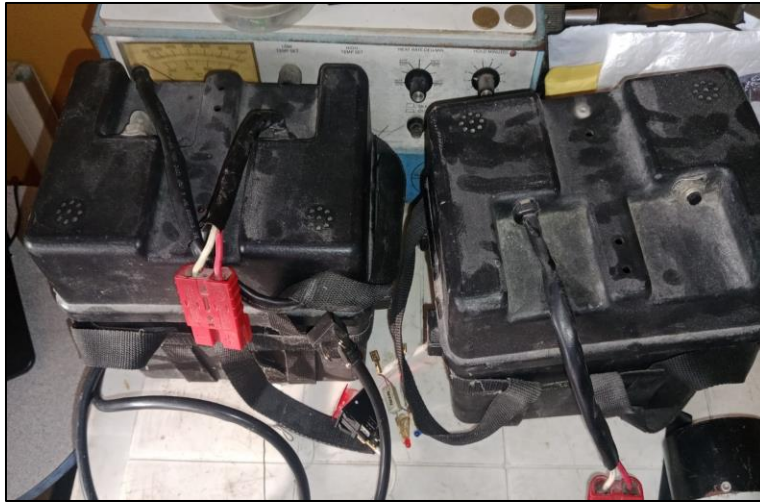
Figura 12. Baterías de 12V 36A. Elaboración propia.
