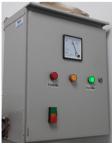
Figura 6. Parada de Emergencia del equipo de Rayos X - TXR SHF-210.
