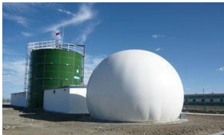
Imagen 8. Tanque de almacenamiento de biogás
