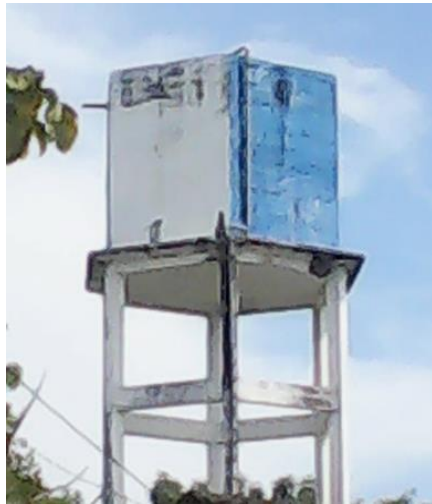
Figura 13. condiciones del tanque de reserva
