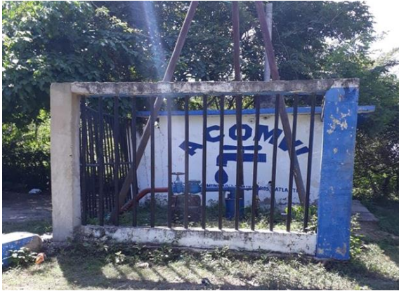
Figura 9. Punto de captación y cloración del agua para consumo humano en el corregimiento de Villa Rosa Atlántico
