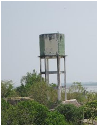
Figura 11. Tanque de reserva
